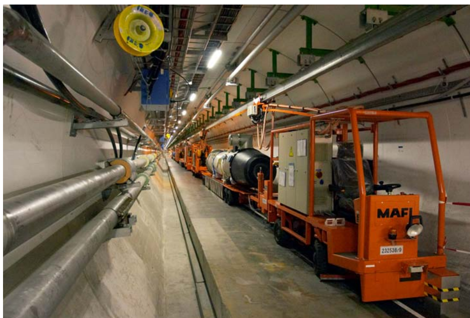
Tunel LHC, w którym montowane są nadprzewodzące magnesy
